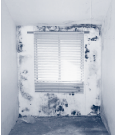
Contamination par la moisissure à l'intérieur d'une maison située dans une réserve.
